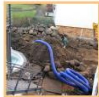
Erdkollektor 1,20-1,30m tief
